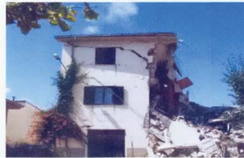
Stato Limite di prevenzione del Collasso (Near Collapse) (Onna)
