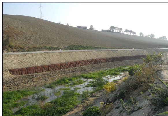
Esempio di protezione spondale realizzata con Erdox Junior (fiume Ete Vivo, Fermo)
