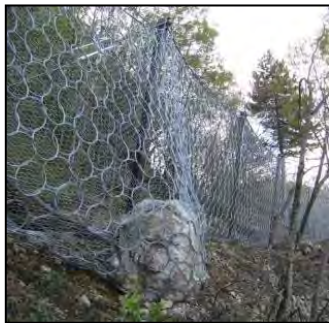
Struttura di intercettazione (rete)
